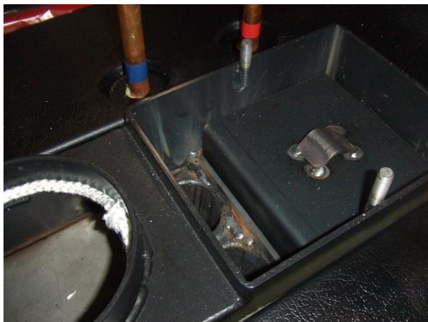
Under locket på toppen av pannan kommer man åt tuberna vid ekonomisötningen
